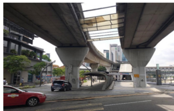
GAMBAR 34. Pandangan terhadap ruang awam terbuka bawah jejambat yang kelihatan suram dan tidak menarik dari jalan utama Sumber: Penulis (2021)
