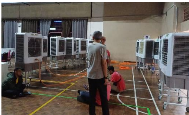
Kerosakan alat penyaman udara di Dewan Gemilang, maka air cooler sebanyak 20 unit telah dipasang.
